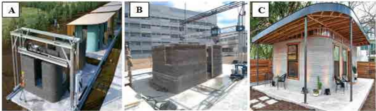
Figura 1- Protótipo da impressora Vulcan da ICON (A), Impressão 3D da casa, com uma argamassa especial de alta resistência (B), Casa impressa em 3D, no canteiro de obras.
