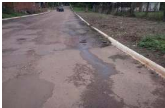
Figura 6: Remendos no pavimento situado na Rua 11, Taquaruçu, Palmas – TO.
