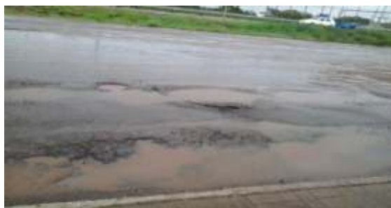
Figura 8: Panelas no pavimento situado na TO-050, Estação Javaé.
