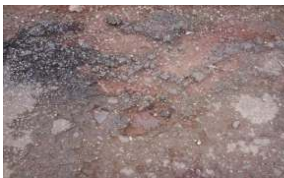
Figura 7: Desagregação do pavimento situado no Parque Cesamar.
