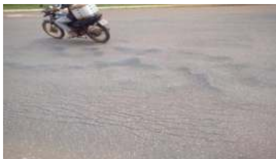
Figura 1: Fendas no Parque Cesamar.
