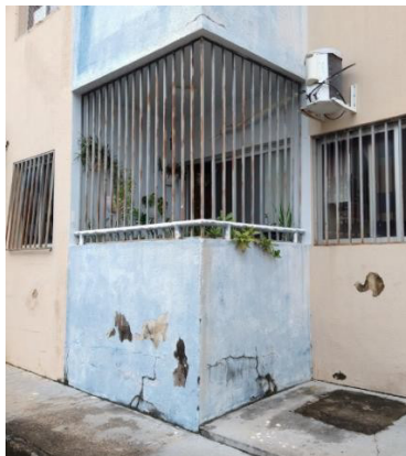
Figura 1 (Rachaduras e pintura manchada da parede)
